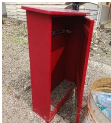
Gambar 5.12 Analisa kondisi hydrant
