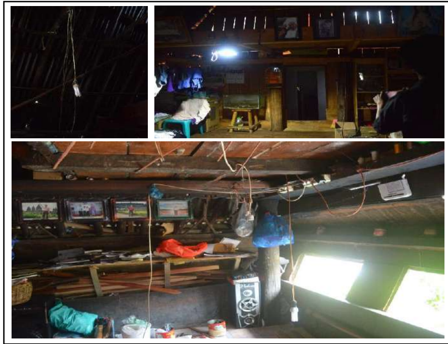
Gambar 4.46 Instalasi listrik dalam bangunan rumah tradisional Batak Toba Desa Hutaraja
